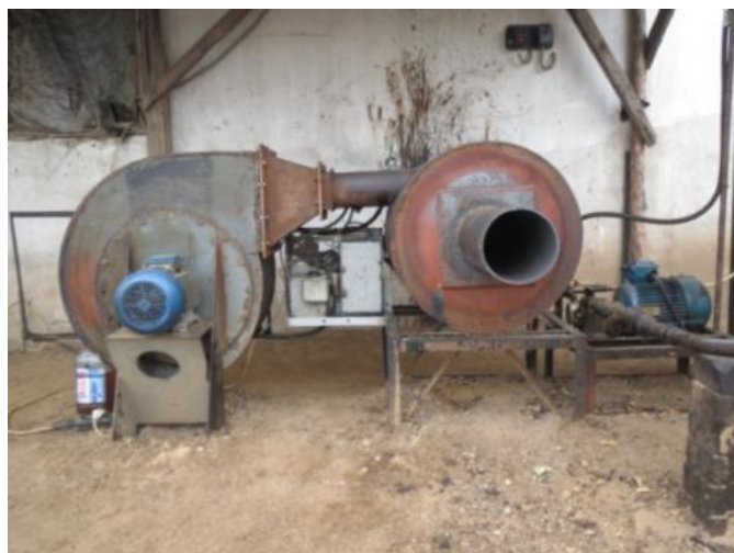
Рис. 1. Горелочное устройство для сжигания ВМЭ Fig.1. Burner device for VME combustion
