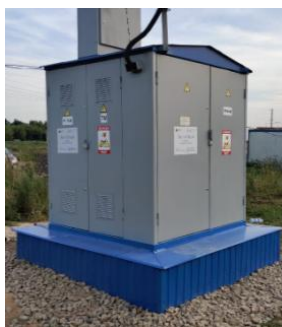
Рис. 12 Фото усовершенствованной «подушки» фундамента КТП киоскового типа Fig. 12 Photo of the improved "cushion" of the KTP kiosk-type foundation
