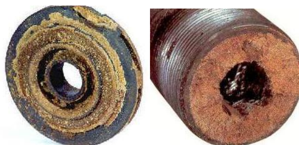
Рис. 1 Асфальто-смолисто-парафиновые отложения в трубопроводе Fig. 1 Asphalt-resin-paraffin deposits in pipeline
