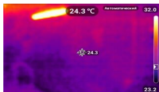
Рис. 6. Термограмма отделительной стены между машинным залом и грабельным отделением
