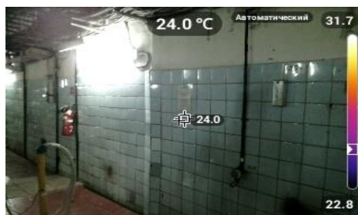
Рис. 5. Внешний вид отделительной стены между машинным залом и грабельным отделением
