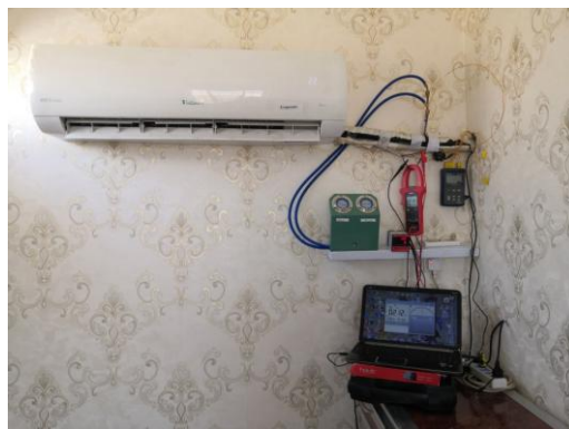
Рис. 4. Фотография кондиционируемого помещения с внутренним блоком
