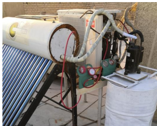
Рис. 5. Наружный блок и солнечный коллектор
