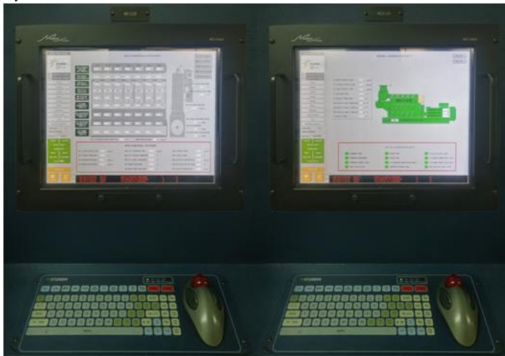
Рис. 2 – Вид постов управления на компьютерной основе Fig. 2 - Computer-based view of control posts
