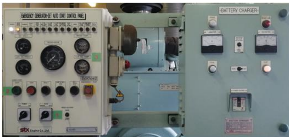
Рис. 5. Вид контрольной панели аварийного дизель-генератора
