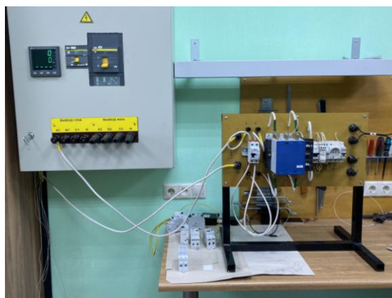
Рис. 6. Лабораторный стенд для проверки УЗДП от параллельного дугового пробоя и искровых промежутков на землю
