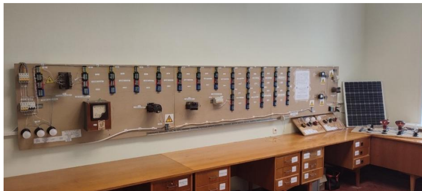
Рис. 2. Внешний вид физической модели сельской электрической сети 0,4 кВ Fig. 2. Appearance of the physical model of the rural 0.4 kV power grid
