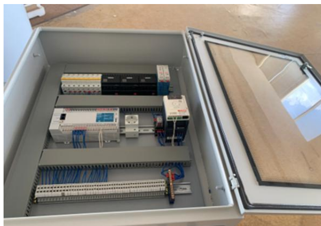
Рис. 4. Шкаф управления накопительным комплексом Fig. 4. Control cabinet of the storage complex
