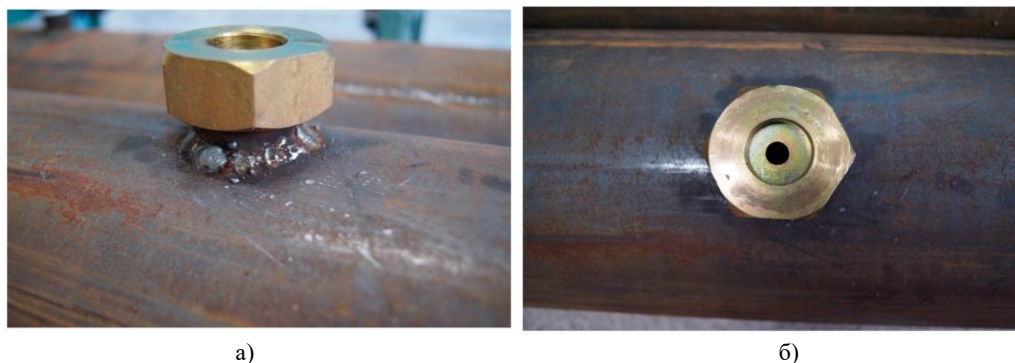
Рис. 6. Способ крепления дисков на трубопроводе: (а) вид сбоку, (б) вид сверху Fig. 6. Method of mounting discs on the pipeline: (a) side view, (b) top view
