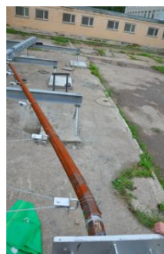
Рис.11. Характер разрушения опоры ОГК-7
