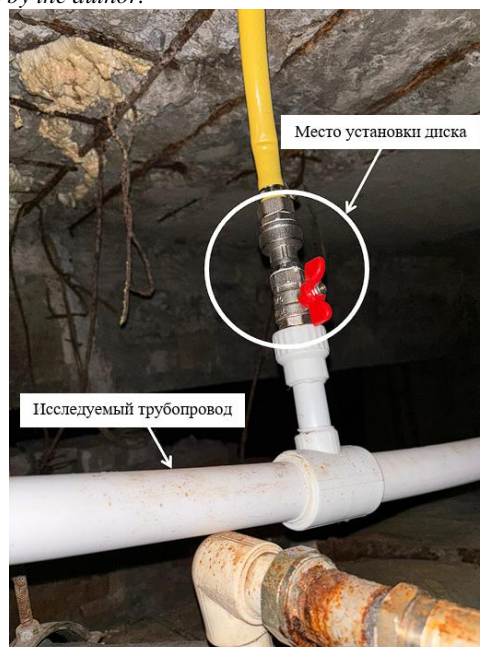
Рис. 9. Фотография места установки диска на полипропиленовом трубопроводе Fig. 9. Photograph of the installation location of the disk on a polypropylene pipeline *Источник: Составлено авторами Source: compiled by the author.
