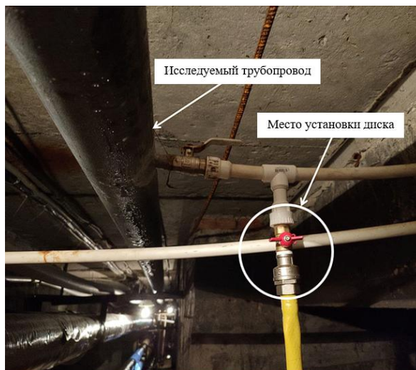
Рис. 7. Фотография места установки диска на стальном трубопроводе Fig. 7. Photograph of the installation location of the disk on a steel pipeline *Источник: Составлено авторами Source: compiled by the author.
