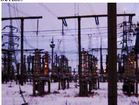
Рис. 2. Оборудование на открытом распределительном устройстве с опасным загрязнением внешней изоляции
