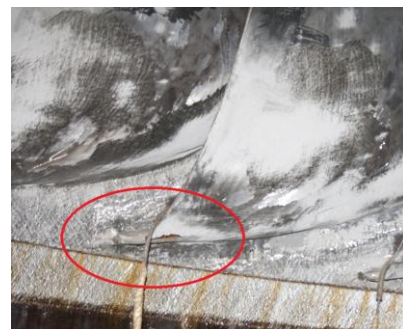
г) дефект в зоне приварки лопасти к ободу РО гидротурбины
