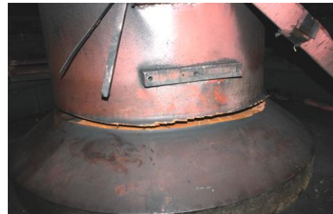
б) трещина в зоне конического перехода вала радиально-осевой гидротурбины
