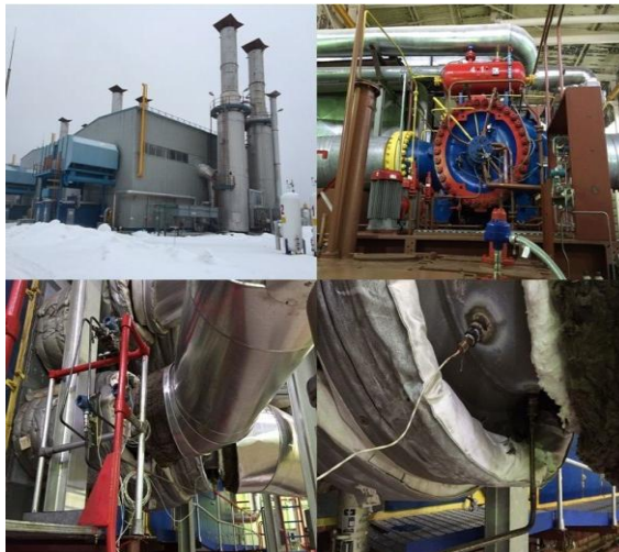
Рис. 1. Специальные теплотехнические испытания ГПА
