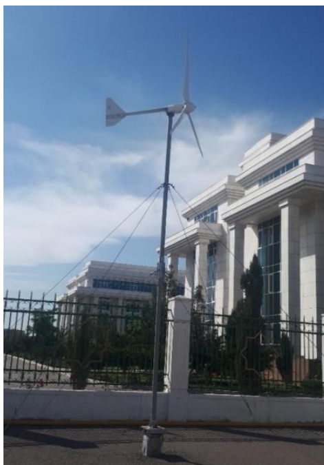
Рис.5. Ветроэлектростанция мощностью 2 кВт установленная на территории ГЭИТ
