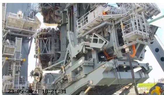
Рис.4. Натяжитель (тензионер) после аварии
