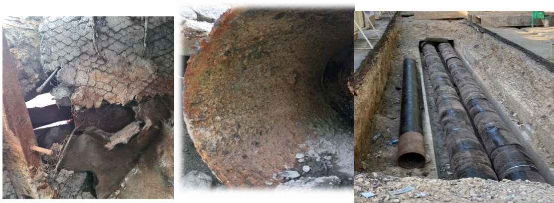
Рис.3. Фактическое состояние основного оборудования (обмуровка котла) и состояние теплотрассы
