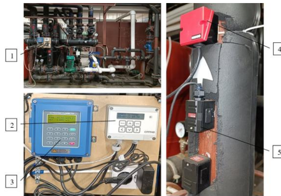
Рис. 5. Стенд для фиксации параметров работы усовершенствованной системы: 1 – место установки измерительного стенда (поз.8 рис.4); 2 – тепловычислитель СПТ-940; 3 – теплосчетчик Streamlux-SLS-720FE; 4 – датчик температуры накладного типа ДТС3225-PT100; 5 – ультразвуковые датчики расхода ТМ-1-НТ
