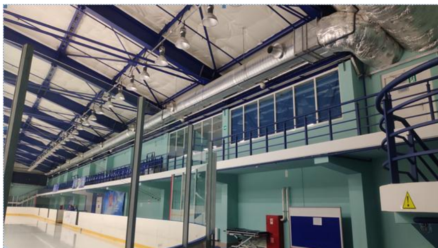
Рис. 2. Вентиляционный канал кондиционера К2
