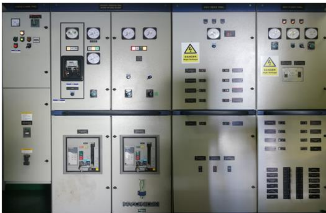
Рис. 4. Вид секций аварийного распределительного щита
