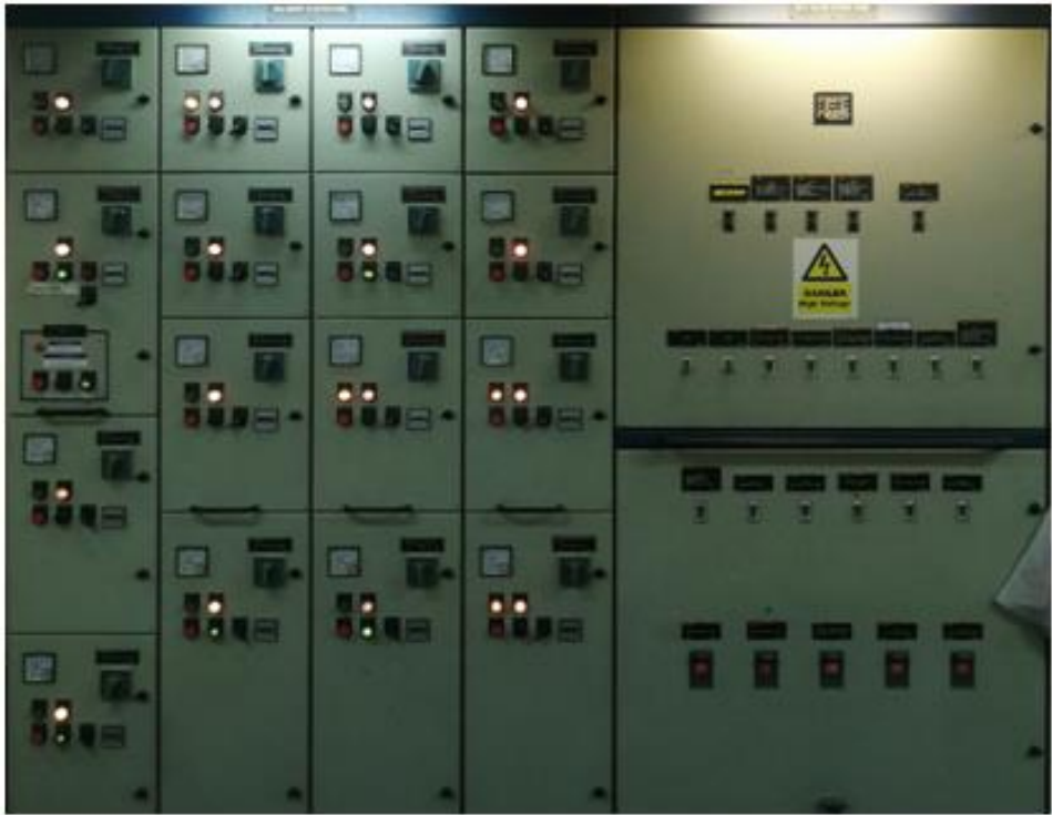
Рисунок 3 – Вид секции «GROUP STARTER PANEL» для потребителей на левый борт и «AC 440V FEEDER PANEL» Figure 3 - View of the "GROUP STARTER PANEL" section for port side customers and "AC 440V FEEDER PANEL" section
