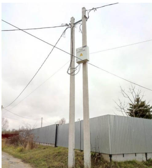
Рис. 1. Устройство секционирования линий электропередачи 0,4 кВ типа МКС-2-3В в ходе опытно-промышленной эксплуатации
