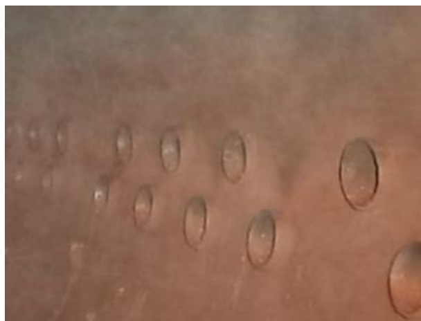
Рис. 5. Состояние стенок теплообменника котла с установленным опытно-промышленным антинакипным устройством
