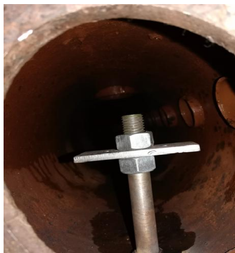
Рис. 4. Внешний вид тест-пластины, установленной в коллекторе котла
