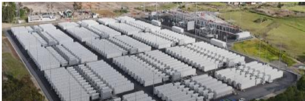
Рис. 1. СНЭЭ проекта «супербатареи» Waratah, Австралия
