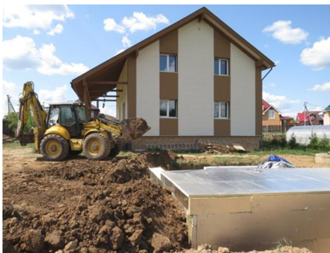
Рис. 2. Процесс монтажа сезонного подземного ТА Fig. 2. Installation process of a TES device
