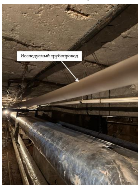
Рис. 8. Фотография полипропиленового трубопровода
